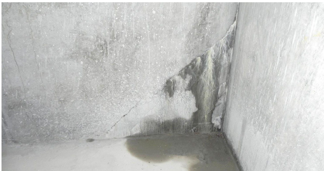
Figur 2. Termorevner er ofte gennemgående og skaber utætheder – også selv om konstruktionen er kraftigt armeret. Allerede efter kort tid vil der ske kalkudfældninger på revnens inderside.
