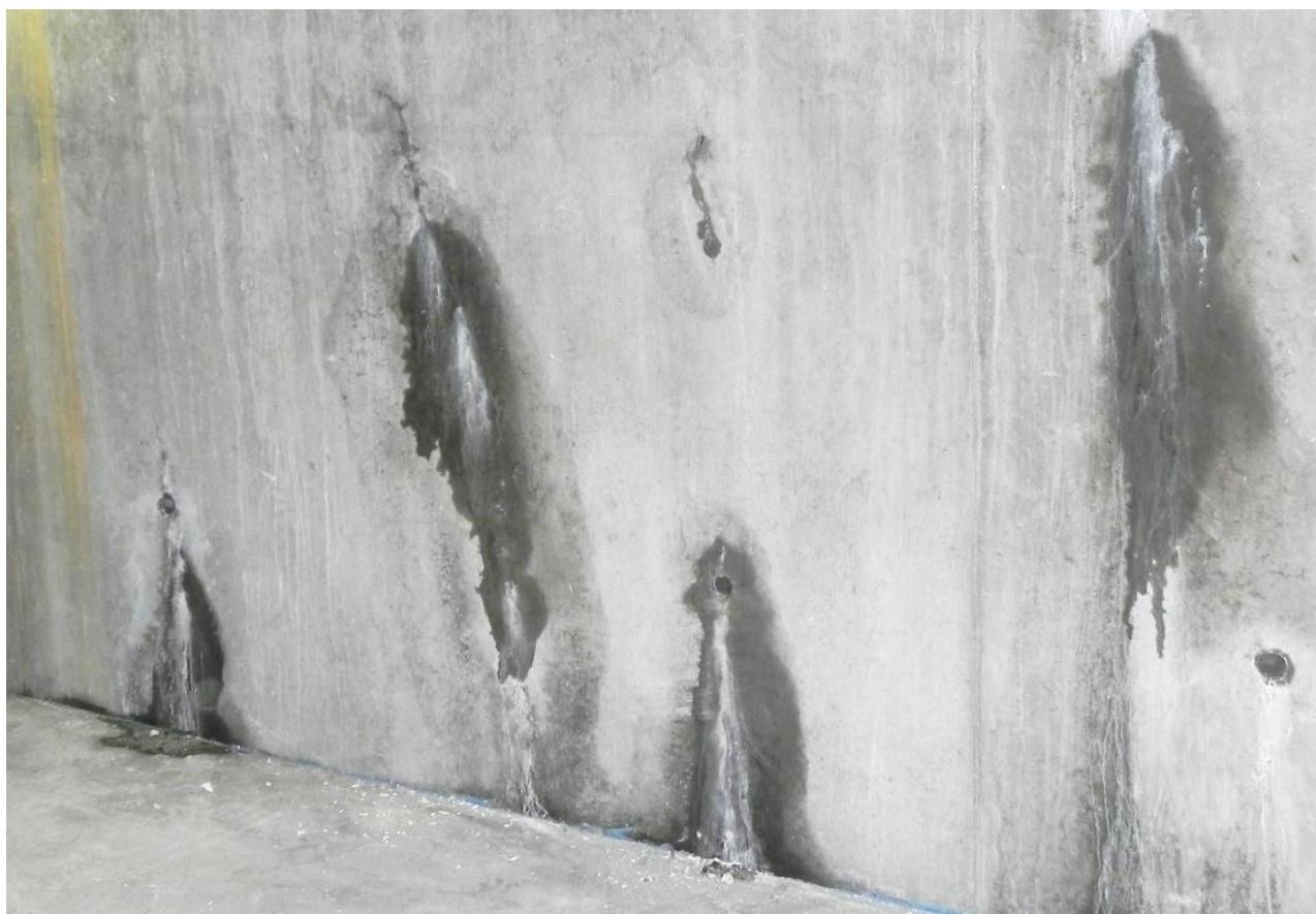
Figur 1. Manglende vandtæthed af en betonkonstruktion er ofte et stort problem. På fotoet ses en vandtrykspåvirket kældervæg med utætheder som følge af revner og dårligt tætnede gennemføringer for clampsjern
