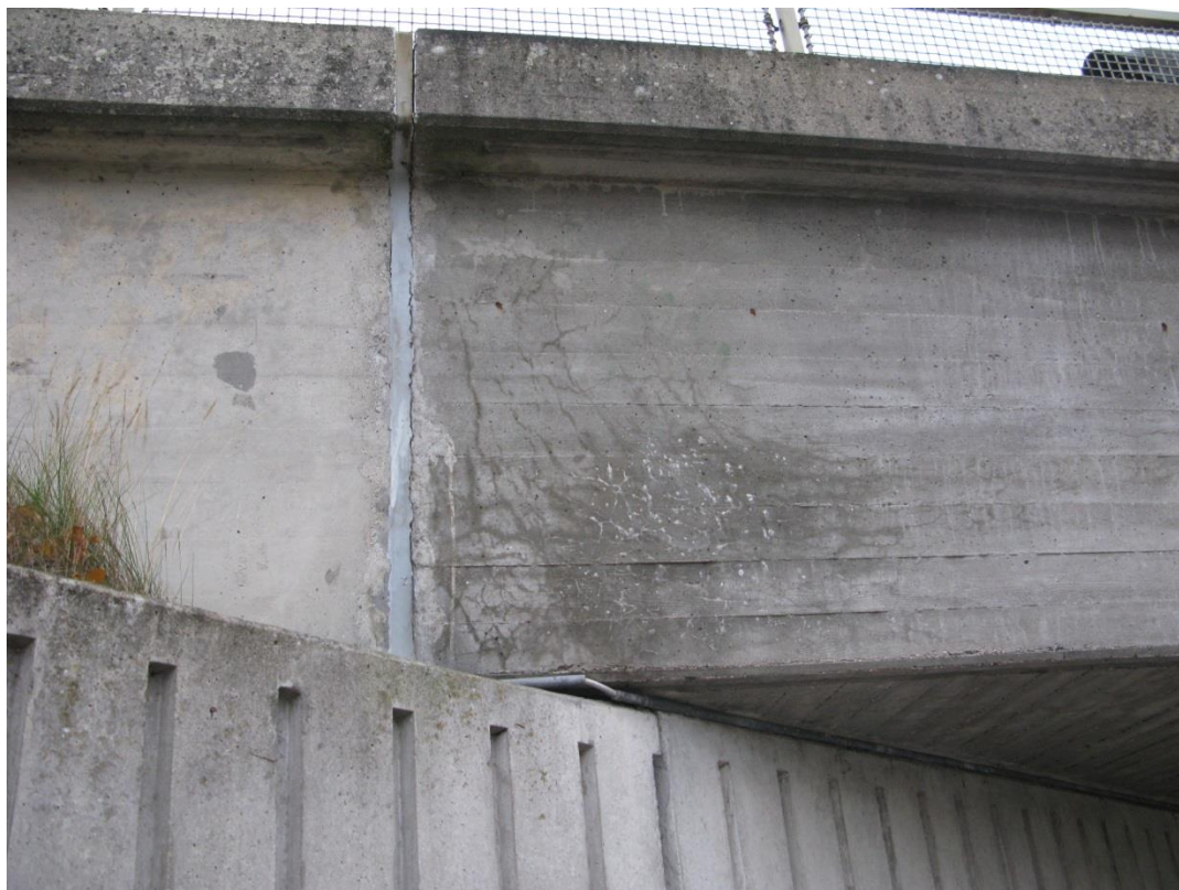
Figur 6. Kantbjælke/facade på en bro fra 1970 med et typisk AKR-revnebillede.
