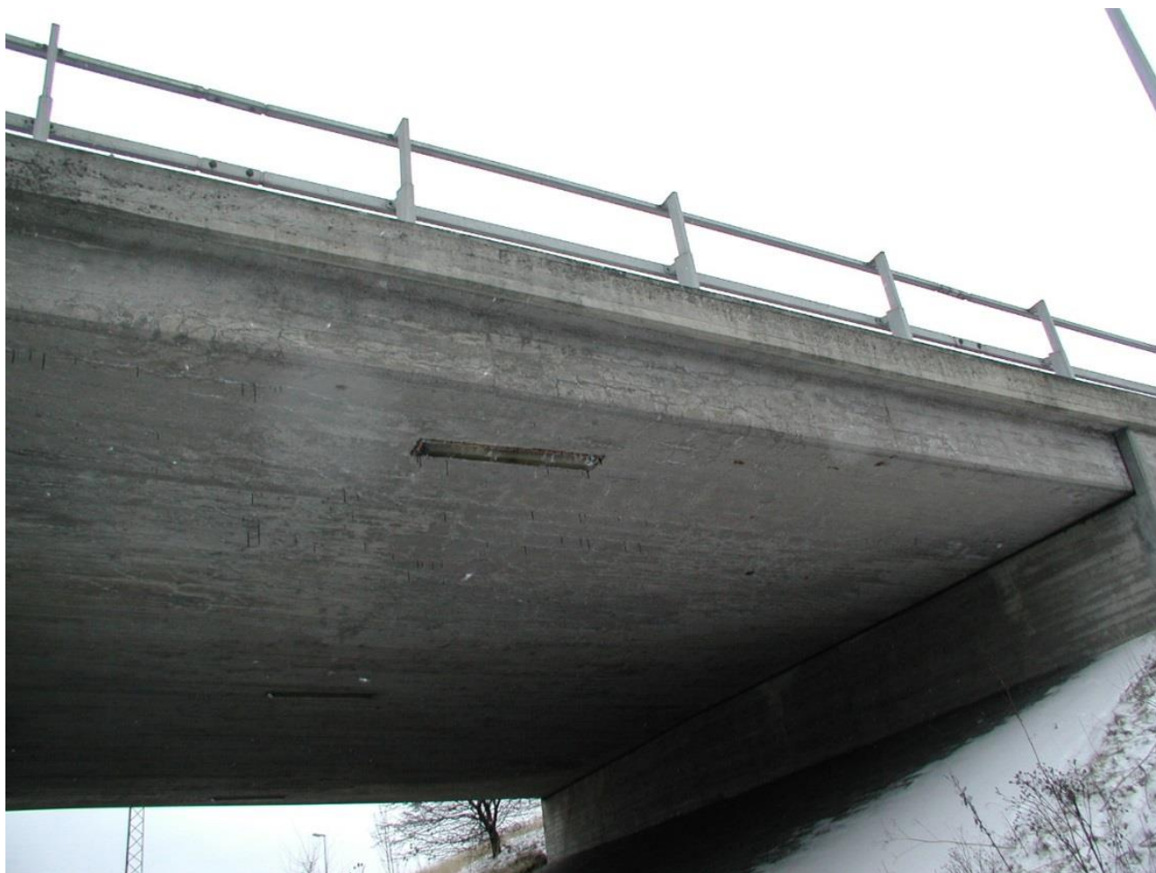
Figur 1. Skader fra alkalikiselreaktioner kan se voldsomme ud med udbredt revnedannelse. Ofte er bygværkets funktion ikke reduceret mærkbart på trods af revnerne.
