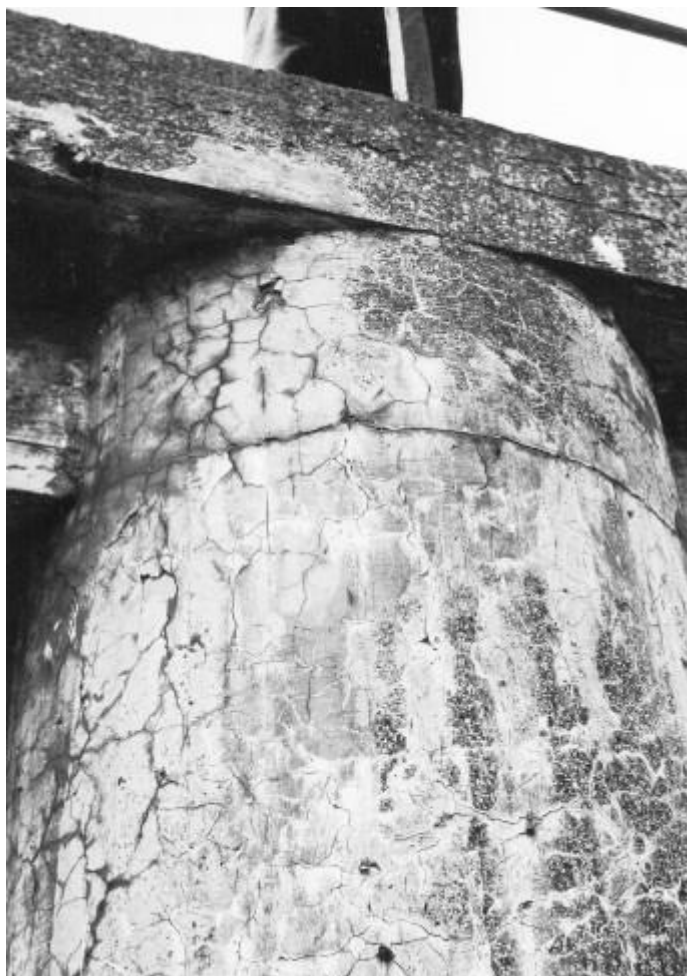
Figur 2. Foto af søjle på Sebbesundbroen fra en af SBI/ATV gennemførte undersøgelser i 1959.
