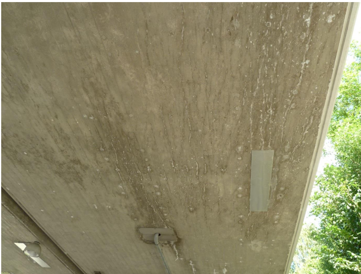
Figur 7. Langsgående orienterede revnedannelser forårsaget af alkalikiselreaktioner i undersiden af et (forspændt) brodæk. Revneorienteringen følger de herskende trykspændinger (for-spændingskræfterne) i betonen.
