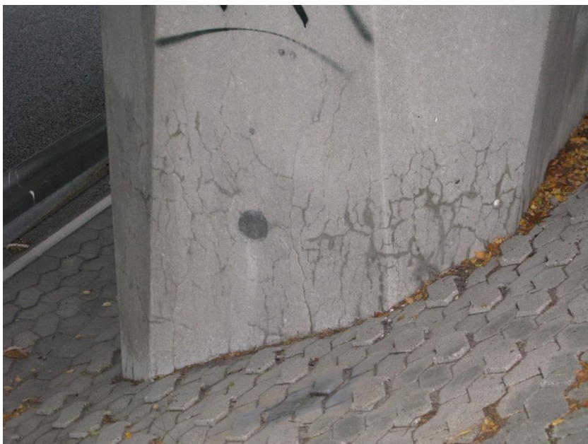
Figur 3: Foto af søjle med revnedannelser forårsaget af AKR på en bro opført i 1970.
