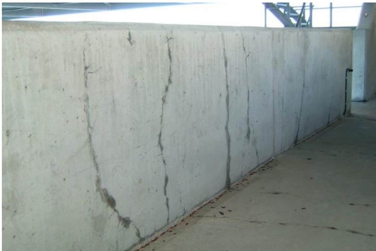
Figur 6. Gennemgående revner i betonvæg opstået som følge af, at væggen under hærdningen er blevet alt for varm i forhold til dækket/fundamentet.
