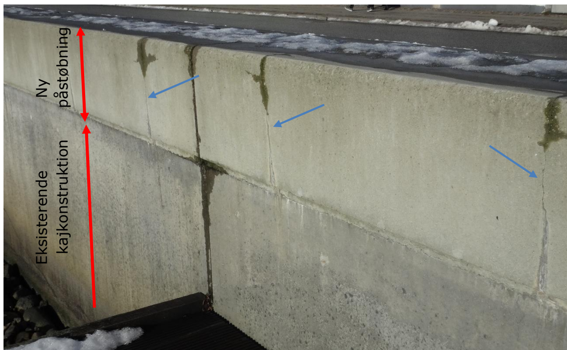
Figur 7. Revner i en påstøbning på en eksisterende kajkonstruktion, hvor den eksisterende konstruktion har medført en langsgående fastholdelse som igen har forårsaget revnedannelse. De blå pile viser revnernes placering
