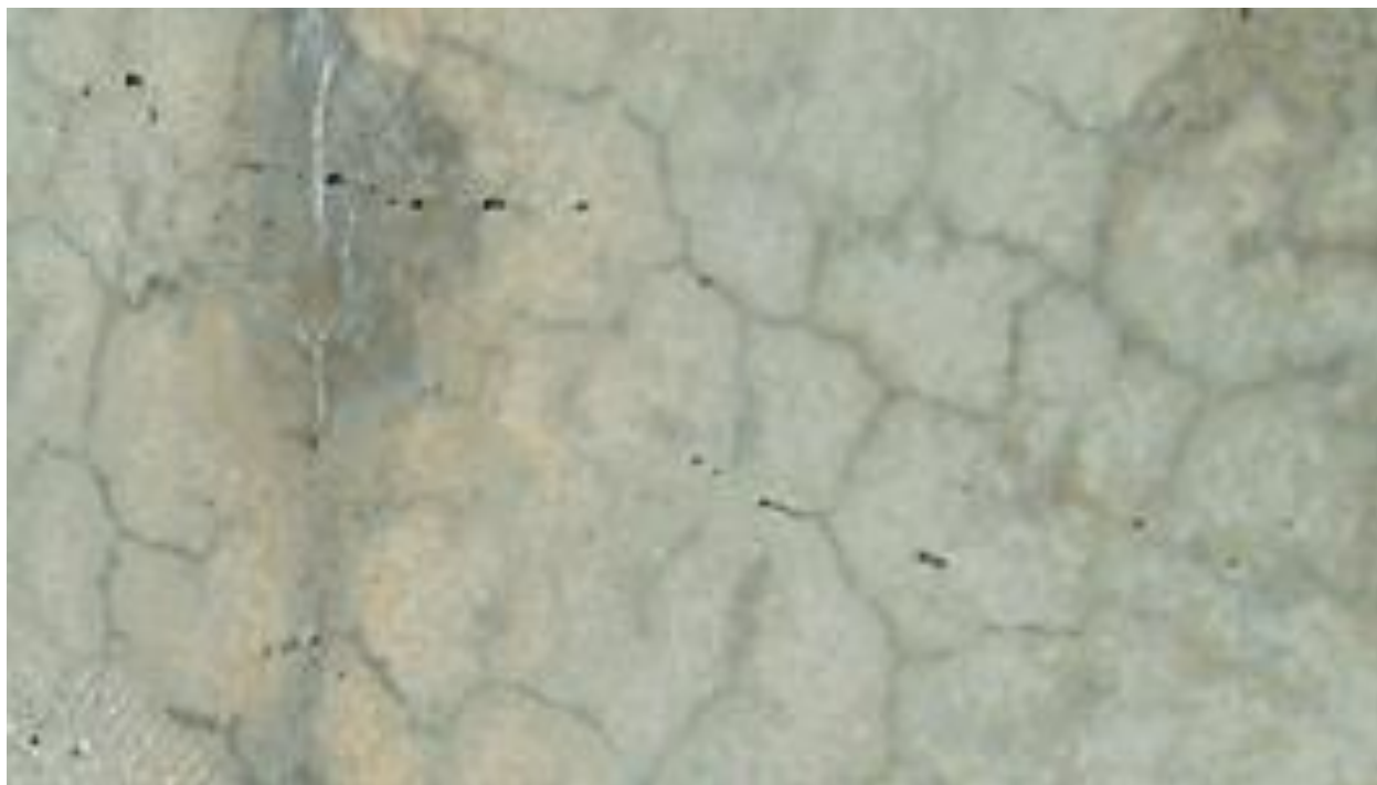
Figur 5. Overfladerevner i form af netrevner opstået som følge af, at formen er fjernet for tidligt uden efterfølgende overfladebeskyttelse.
