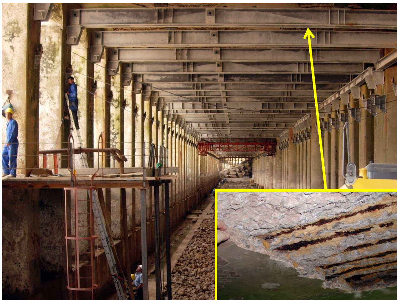
Figur 2. Undersiden af en betonplatform beliggende ca. 10 m over havet (på billedet er havet holdt tilbage af en midlertidig dæmning). Salt fra havvandet er trængt ind i betonen og chlorid har fået armeringsstålet til at ruste i udbredt grad. Rust kan fylde op til syv gange så meget som stål, hvorfor betondæklaget uden på armeringen kan sprænges af, når rustprocessen er udbredt og har forløbet i passende lang tid.
