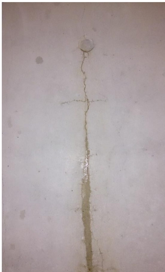
Figur 2. Når betons trækstyrke overskrides, opstår der revner. En revnet betonkonstruktion ser ikke pæn ud, og revner kan have afgørende negativ betydning for en funktionen – specielt hvis konstruktionen er udsat for ensidigt vandtryk og skal være vandtæt.
