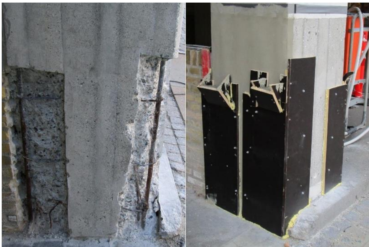
Figur 1. Reparation af søjle med delvis rusten armering. Der findes også krav til udførelse af reparationer. Begrænset antal revner/skader i oprindelig såvel som i ny beton; Fuld kontakt i en stor del af støbeskellet; God komprimering – lav hulrumsprocent i reparationen; Reparationens sammensætning skal være som forventet.
