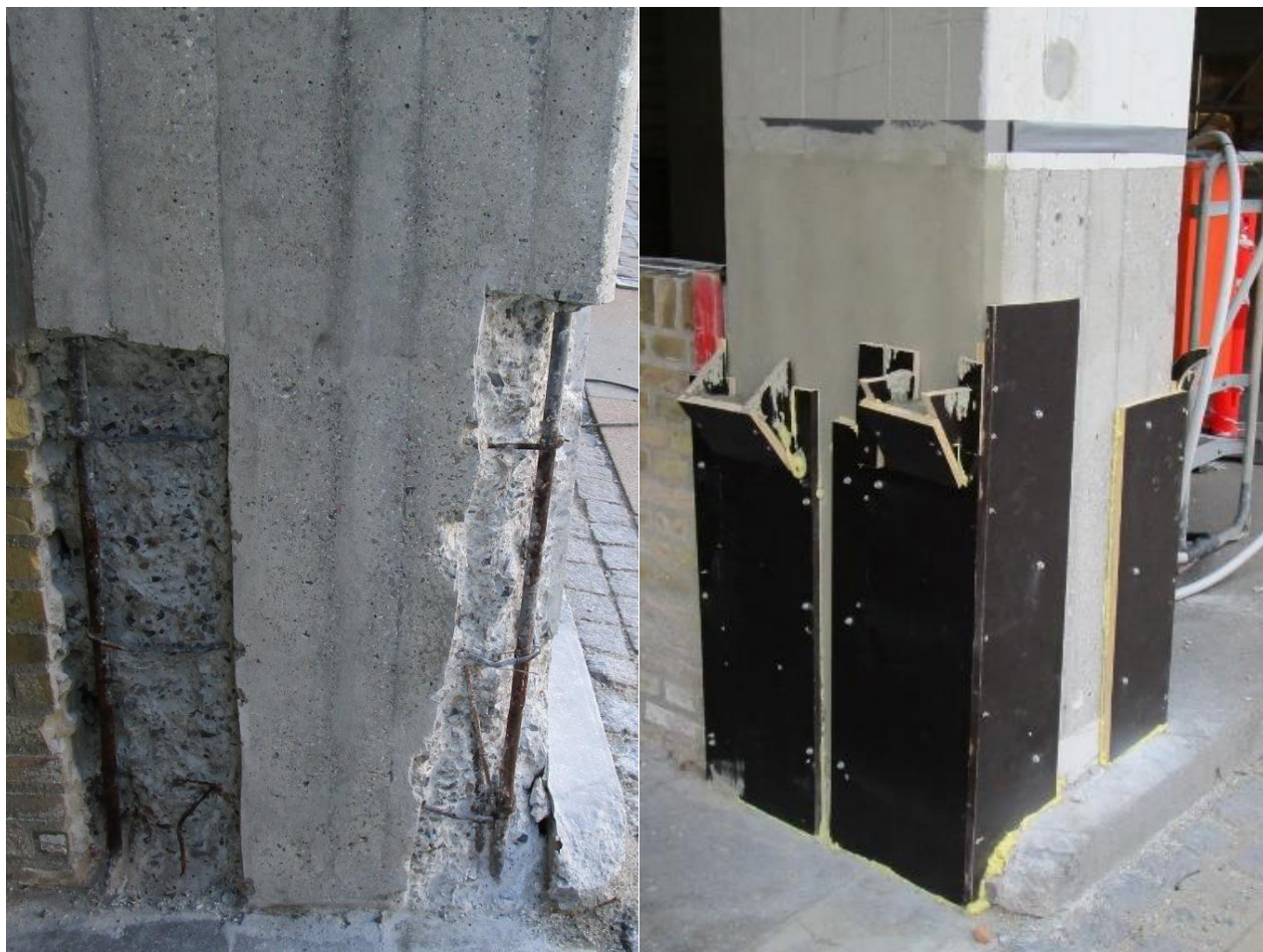
Figur 5. Reparation af søjle med delvis rusten armering. Tv. pågår klargøring af reparationsstedet og th. er der støbt ud ved blødstøbning med en letflydende reparationsbeton i forme indrettet med 'støbetude' i overhøjde i forhold til reparationsstedernes øverste kanter. Disse 'støbetude' afhugges ved afformning, hvorefter der efterrepareres med tyndpudsmørtel.
