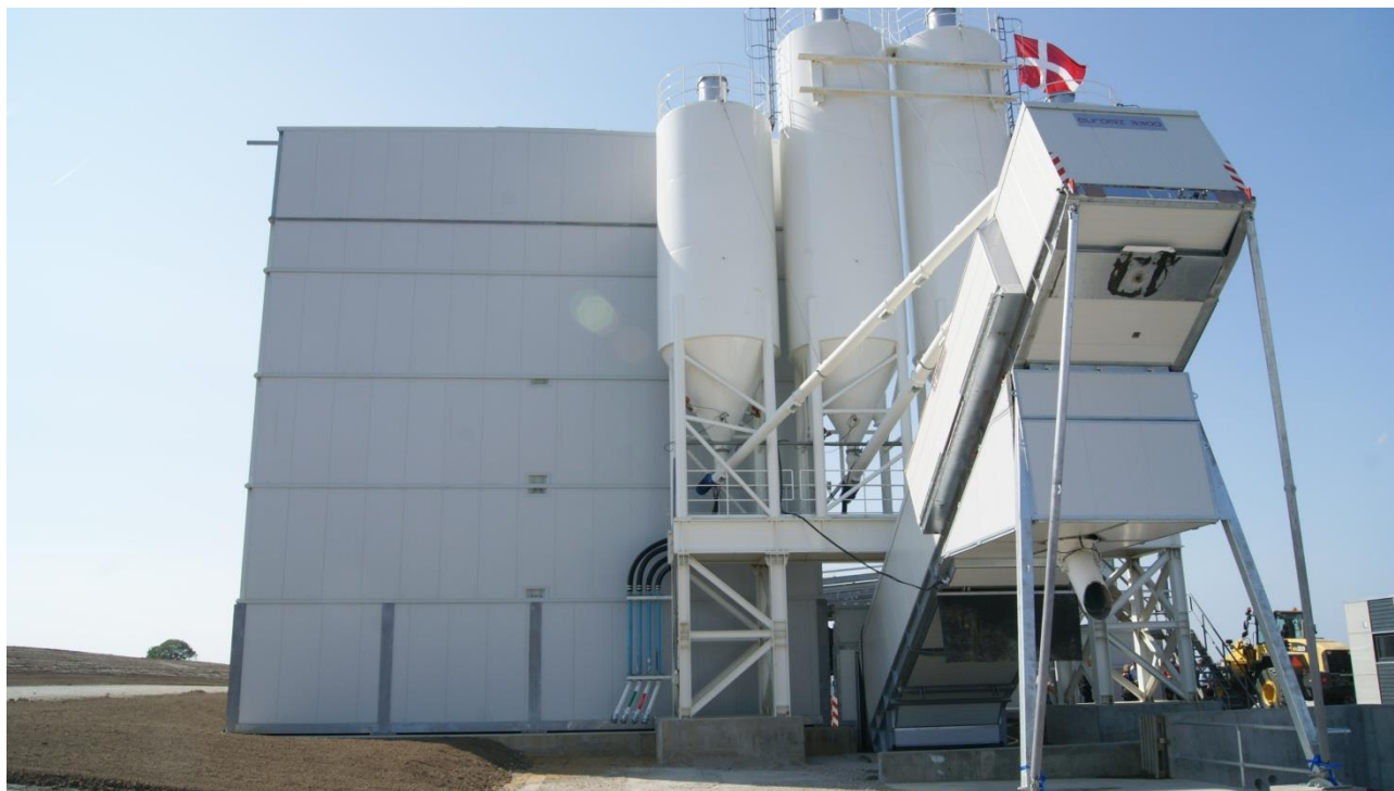
Figur 1. Frisk beton produceres på en betonfabrik. Ved tuden til højre i billedet påfyldes roterbilerne. Umiddelbart ovenover er selve blanderen placeret. Den firkantede bygning indeholder tilslagssiloer, mens pulvere som cement og flyveaske er i de runde siloer
