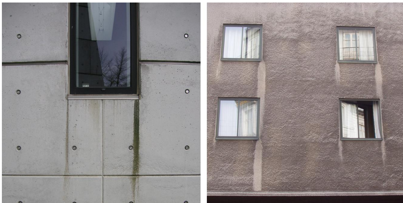
Figur 43. Tv: Tydelig begroning i striber under drypnæse fra vinduer på Retsbygningen i Holstebro. Th: Samme detaljering, men her skaber afvandingen en egentlig afvaskning af overfladen i striber på Hotel Astoria i København fra 1935 af Ole Falkentorp. Resultatet for begge eksempler er uensartet patinering under vinduer.
