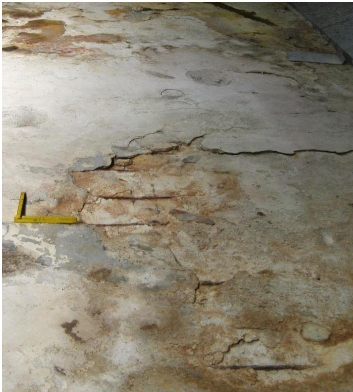
Figur 12. Smuldret betongulv i en kemifabrik forårsaget af kemisk nedbrydning af betonoverfladen.
