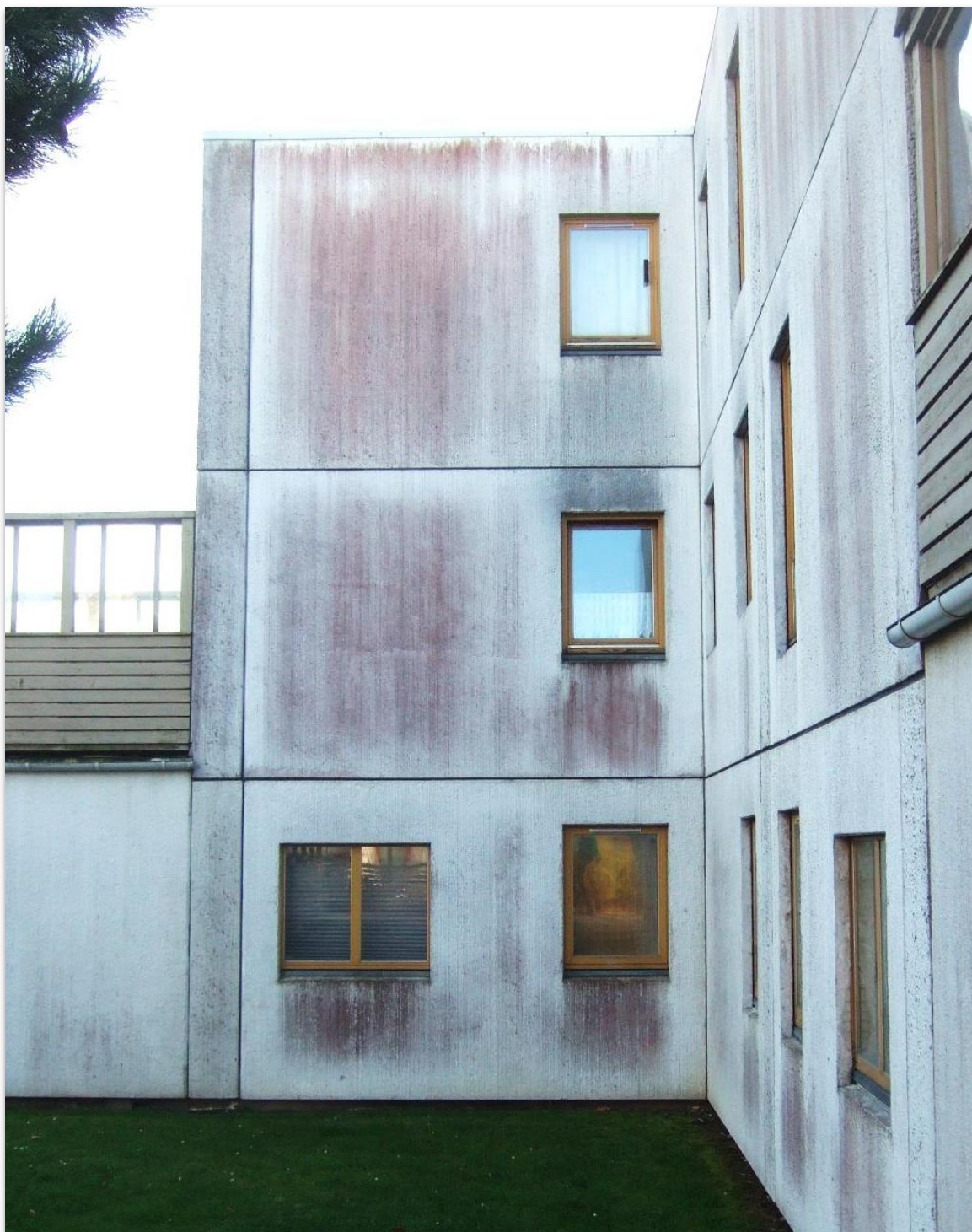
Figur 31. Rød og sort misfarvning af hvid betonfacade. Misfarvningen skyldes algevækst på overfladen. Variationen i algevækst og algetype skyldes variation i temperatur- og fugtforhold.
