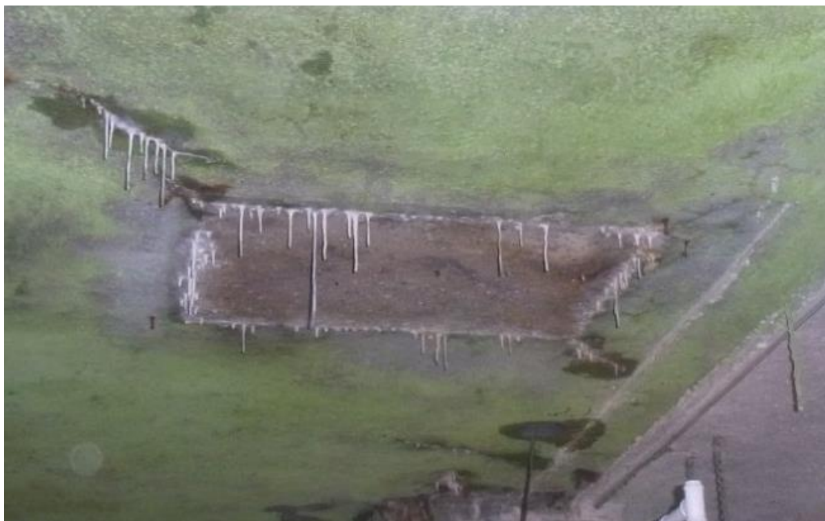
Figur 27. Gennemsivninger med kalkudfældninger i dæk under gårdkælder. Udfældninger ses i revner og i støbeskel mellem dæk og betonreparation. En utæt membran på oversiden af dækket er årsag til gennemsivningerne.
