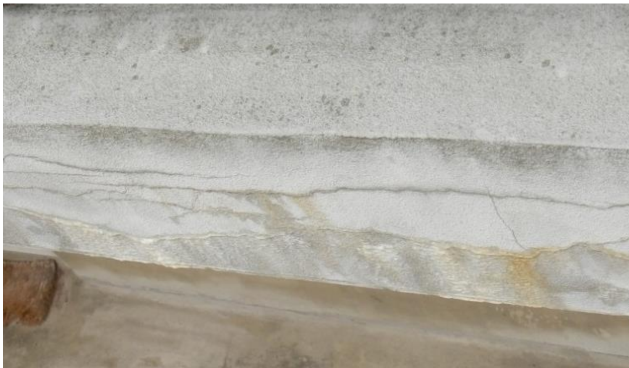
Figur 23. Revner/delamineringer i svalegangsdæk forårsaget af frost/tø-påvirkning. Delamineringer af denne type kan være "skjulte" på konstruktioner med dækkede lodrette flader, men her kan det observeres på forkanten af svalegangsdækket.
