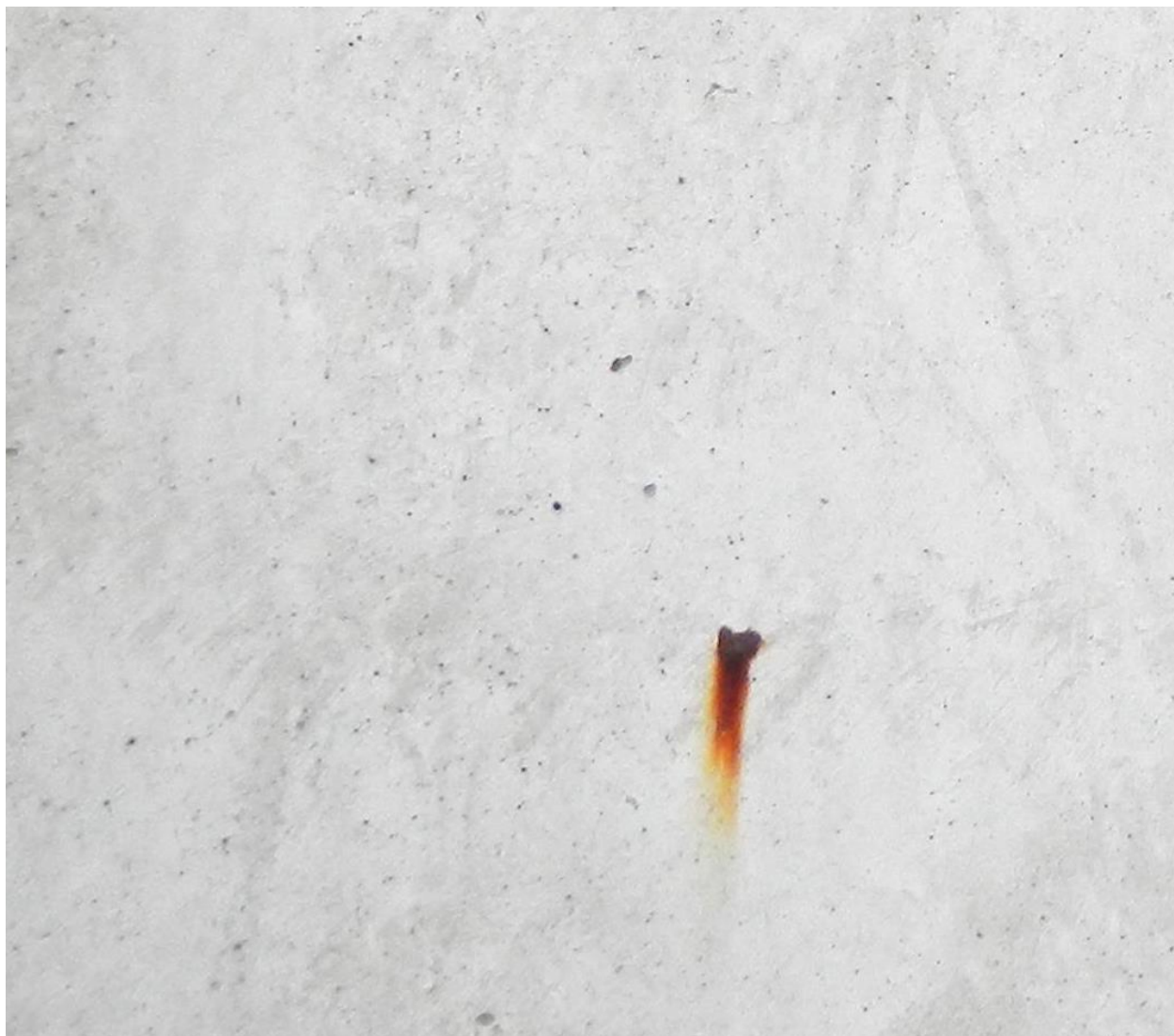
Figur 32. Tilslag af lerjærnsten giver rustfarvede udfældninger på betonoverfladen. Selv om denne type rustudfældning er en skade af rent kosmetisk art, kan den være meget generende på konstruktioner, hvor betonens udtryk er afgørende.
