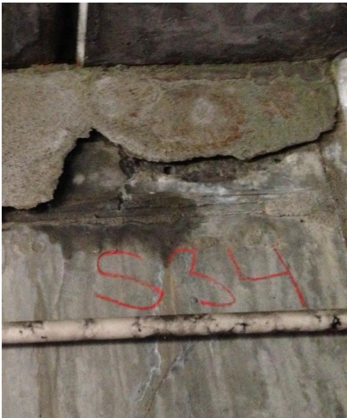
Figur 10. Afskalning i top af søjle ved samling mellem søjle og dæk. I dette tilfælde er der tale om en bevægelsesbetinget afskalning pga. manglende bevægelsesmuligheder for betonen. Der ses her ingen armeringskorrosion eller synlig armering på bagside af afskalning.
