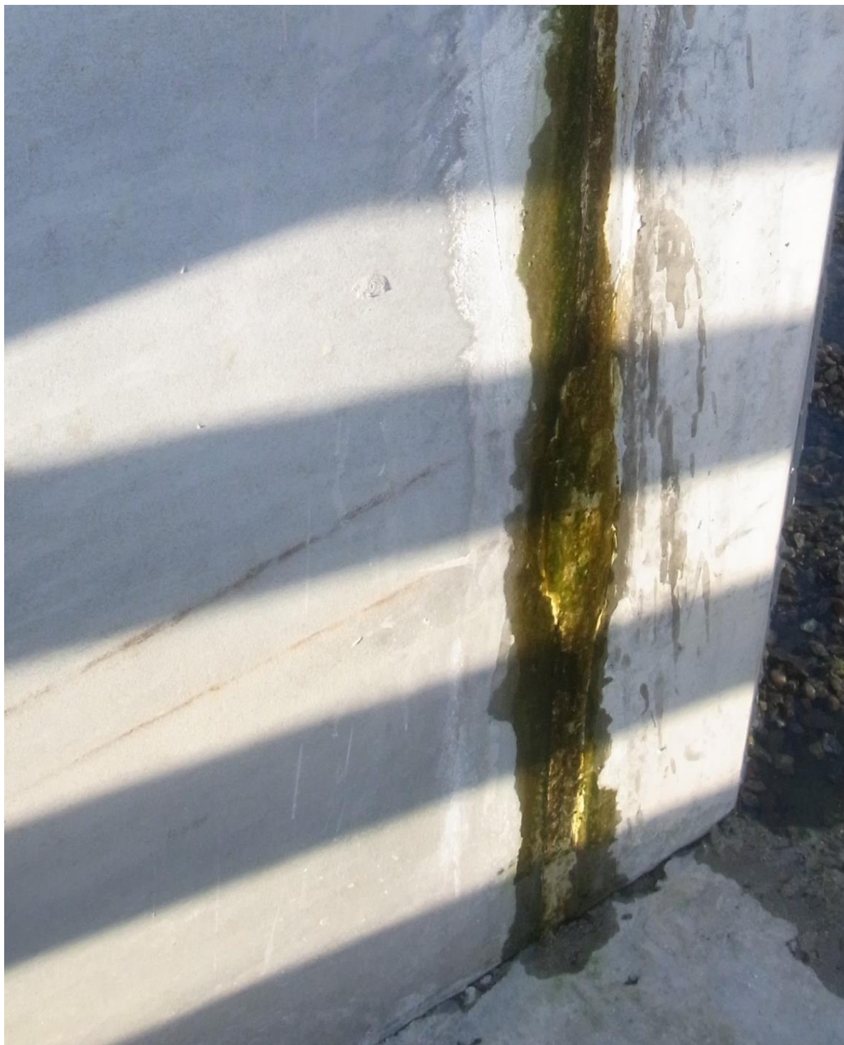
Figur 26. Utæt hjørnesamling i vægge til dambrug. Revner er opstået pga. konstruktionens manglende evne til at optage de temperaturbetingede bevægelser. Væggene er sammenhængende over en strækning på 72,5 m, og der er ikke anvendt dilatationsfuger.
