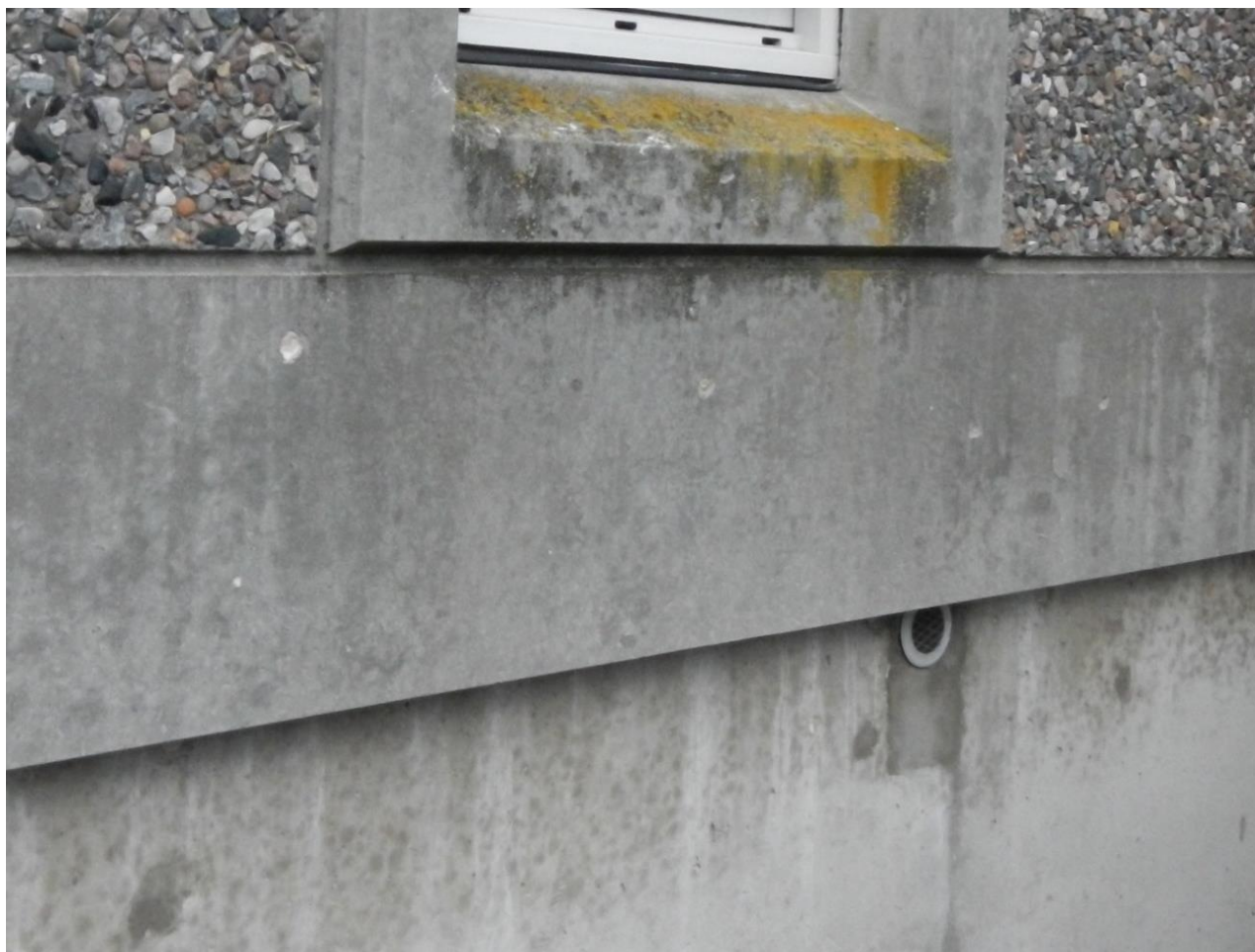
Figur 18. Springere i tå af facadeelement forårsaget af frostpåvirkning. Disse har kun kosmetisk betydning for konstruktionen.
