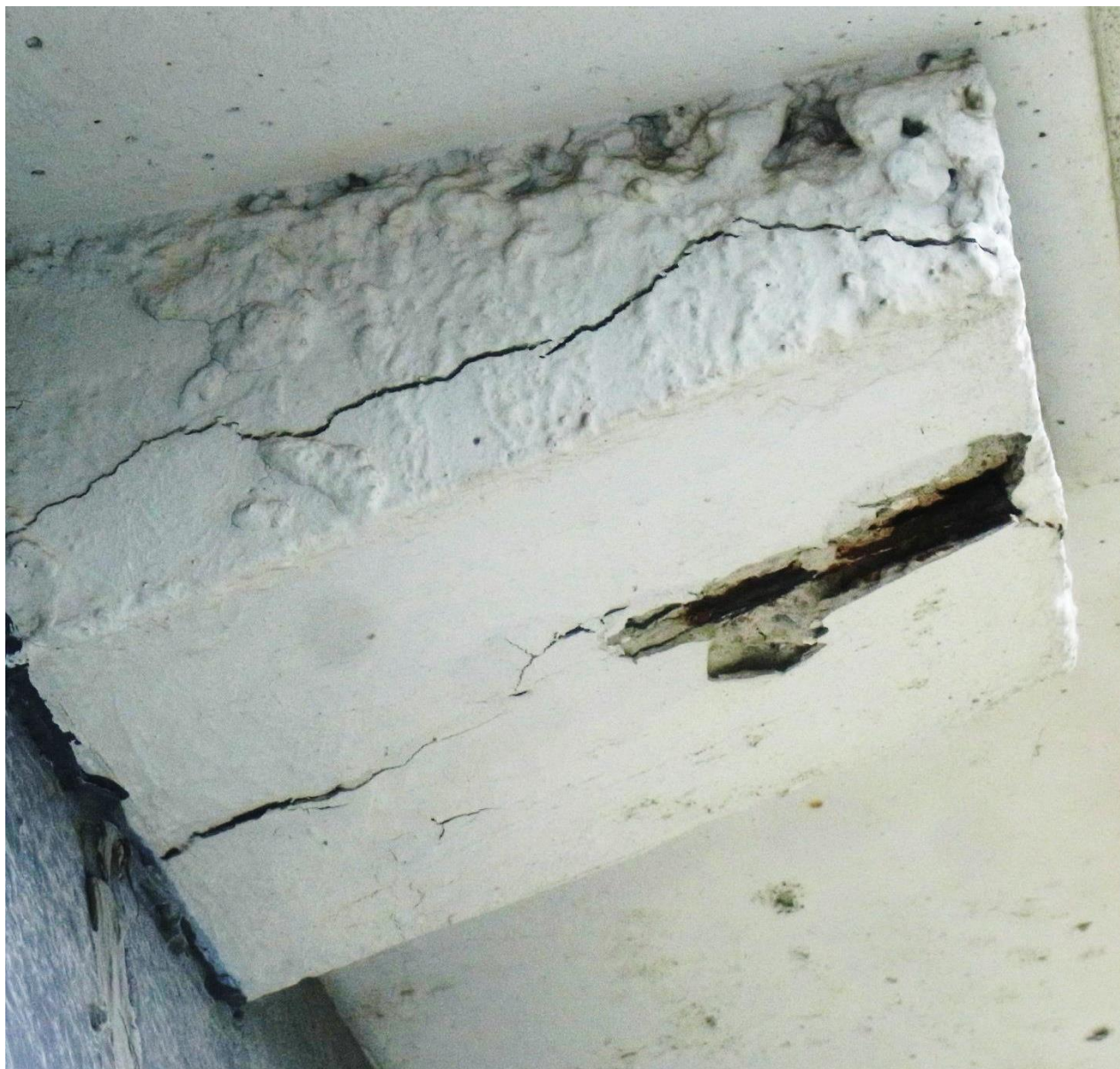
Figur 25. Revne i konsol forårsaget af armeringskorrosion. Beton er karbonatiseret og fugt-påvirket.
