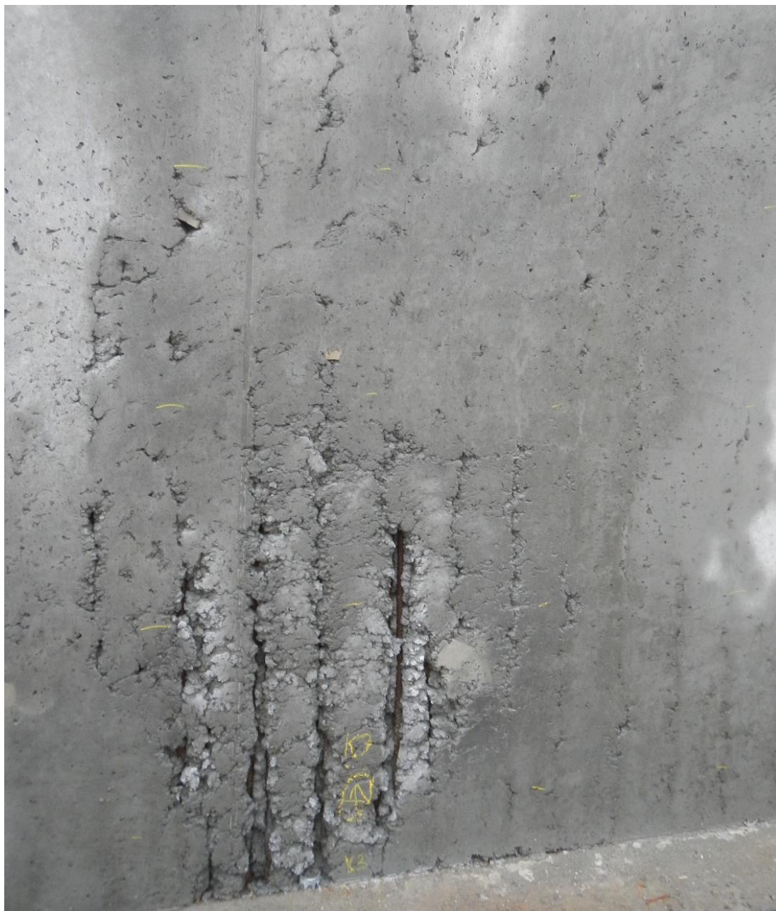
Figur 4. Stenreder i betonvæg. Stenreder af denne type kan opstå som følge af manglende komprimering af betonen, eller de kan skyldes for lille dæklag i relation til betonens maksimale stenstørrelse.
