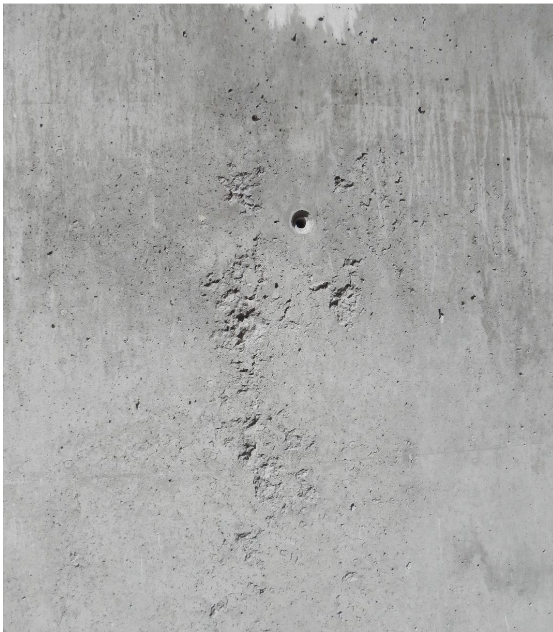
Figur 5. Afskalninger i overflade af nystøbt væg. Afskalningerne er dannet ved afformning, hvor betonen har hængt ved forskallingen, formentlig fordi denne ikke har været tilstrækkeligt smurt med formolie.
