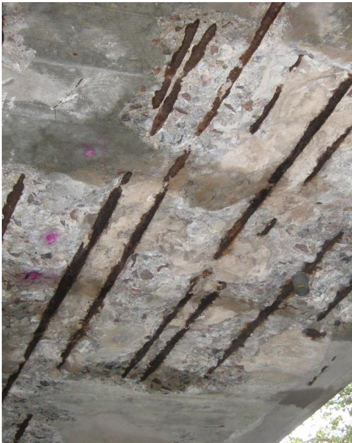
Figur 8. Afskalning i underside af dæk. Korrosionsprodukter fra armeringen har sprængt dæklaget af. Armeringen er her udført med for lille dæklag.
