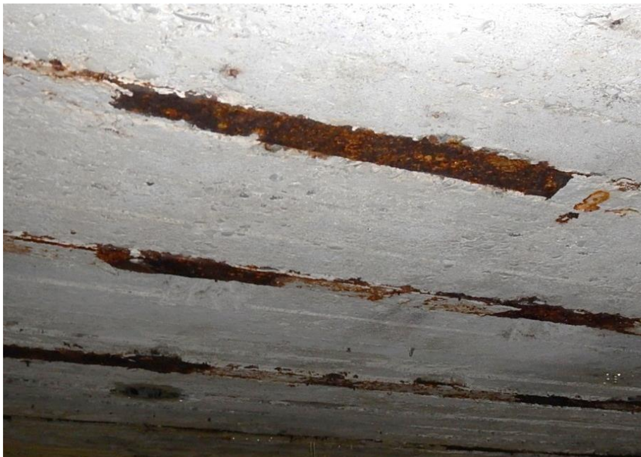
Figur 34. Korrosion på stålprofiler i betondæk over gårdkælder. Højt chloridindhold i betonen pga. tørsalting af overliggende belægning samt adgang for fugt pga. utæt membran.
