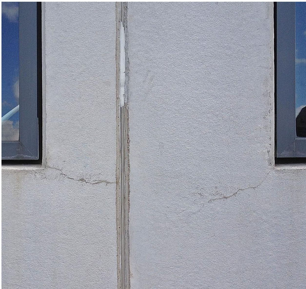
Figur 24. Kraftige revner i sandwichelementer radierende fra hjørner af vinduesåbninger; såkaldte kærrevner. Opstået som kombination af svind og utilstrækkelig armering omkring hjørner.
