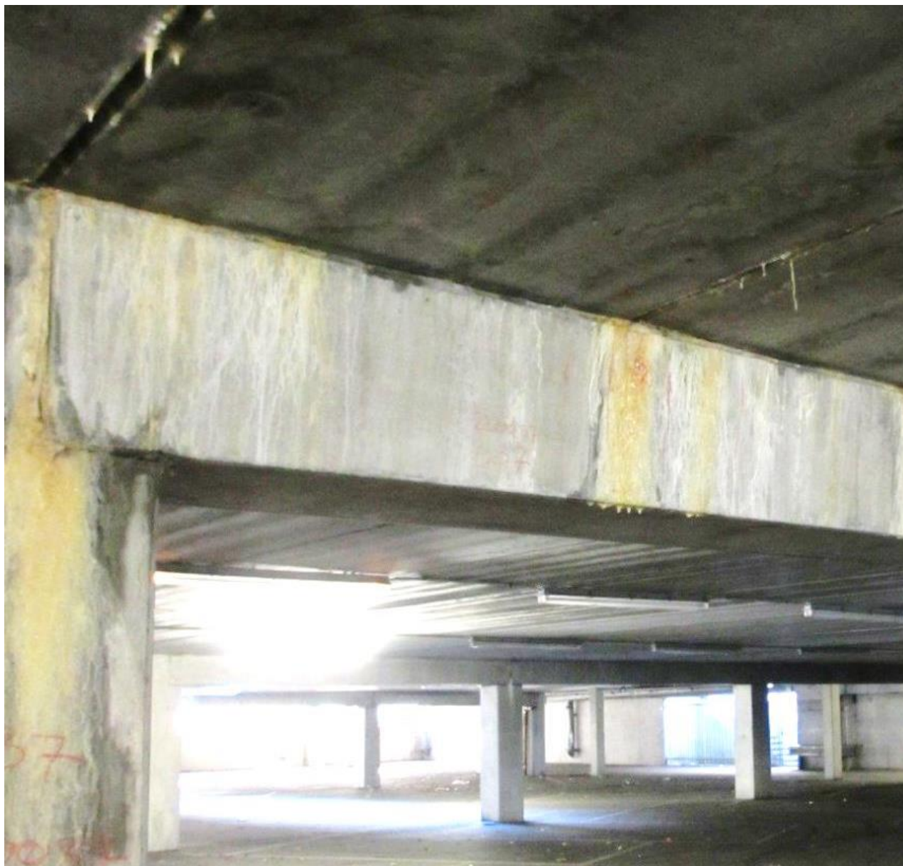
Figur 28. Drypsten i samlinger mellem huldækelementer samt kalkbelægninger på søjle og bjælke i P-kælder. En utæt membran på overside af dæk er årsag til gennemsivningerne.
