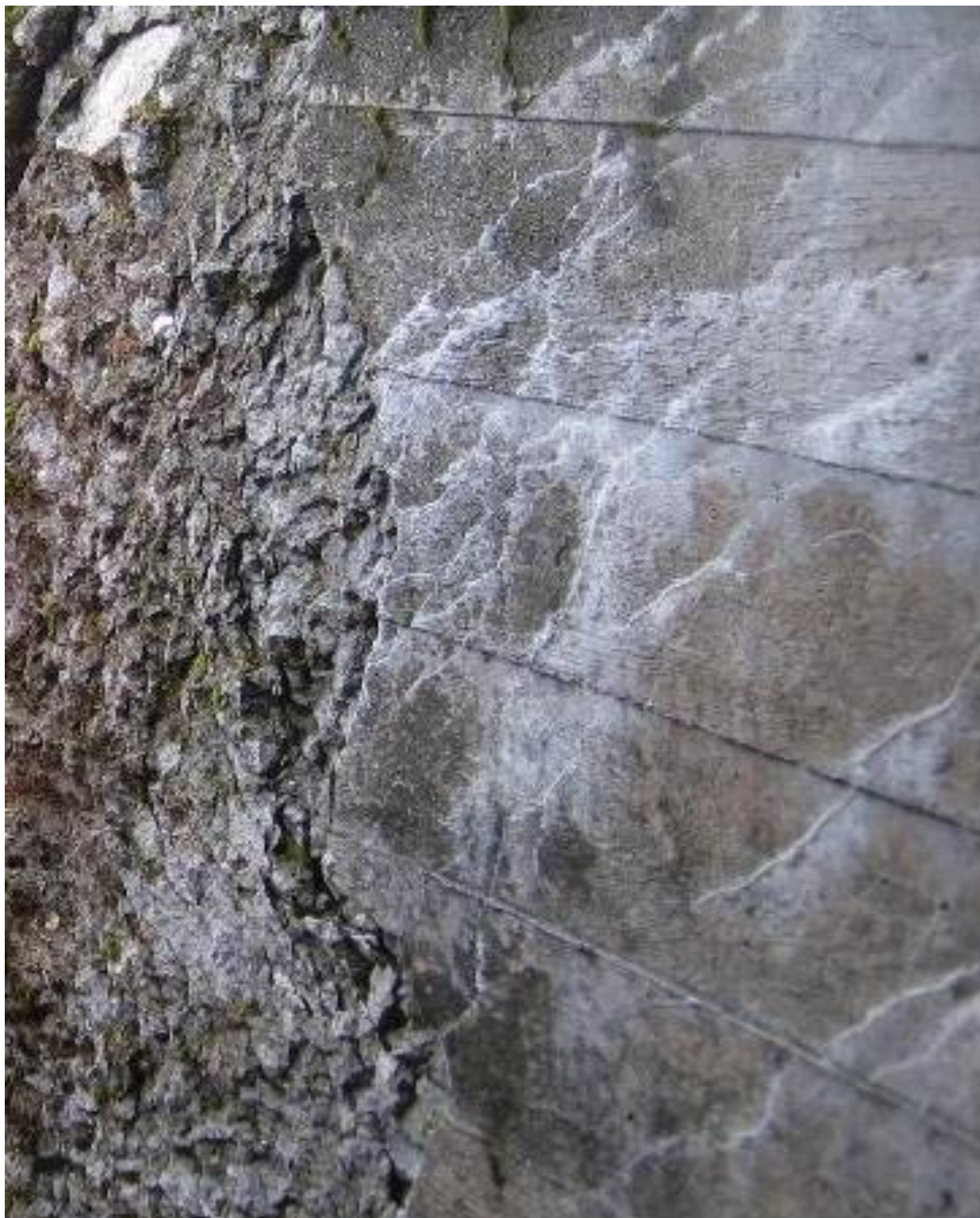
Figur 14. Smuldret beton. Alkalikiselreaktioner har skabt revner i betonen, hvor fugtpåvirkning og frostangreb har ført til en omfattende smuldring af betonen.
