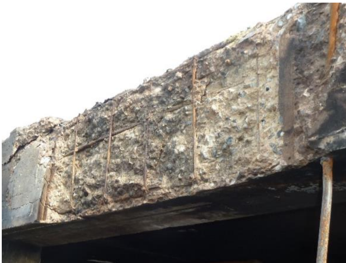
Figur 13. Kraftigt afskallet beton forårsaget af brandpåvirkning.
