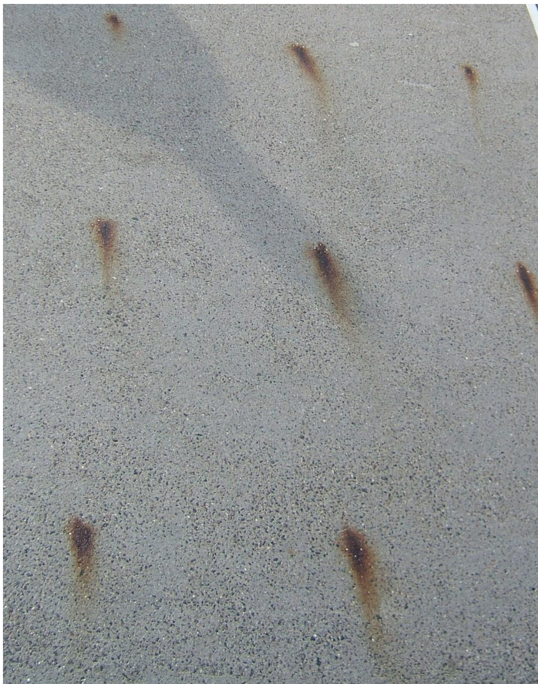
Figur 2. Forkert valg af materialer til konstruktion nær havvand. Afstandsklodser i plastik trækker sig sammen, hvilket betyder, at chlorider og fugt har adgang til armeringen, hvilket igen medfører rustudfældninger på betonoverfladen.
