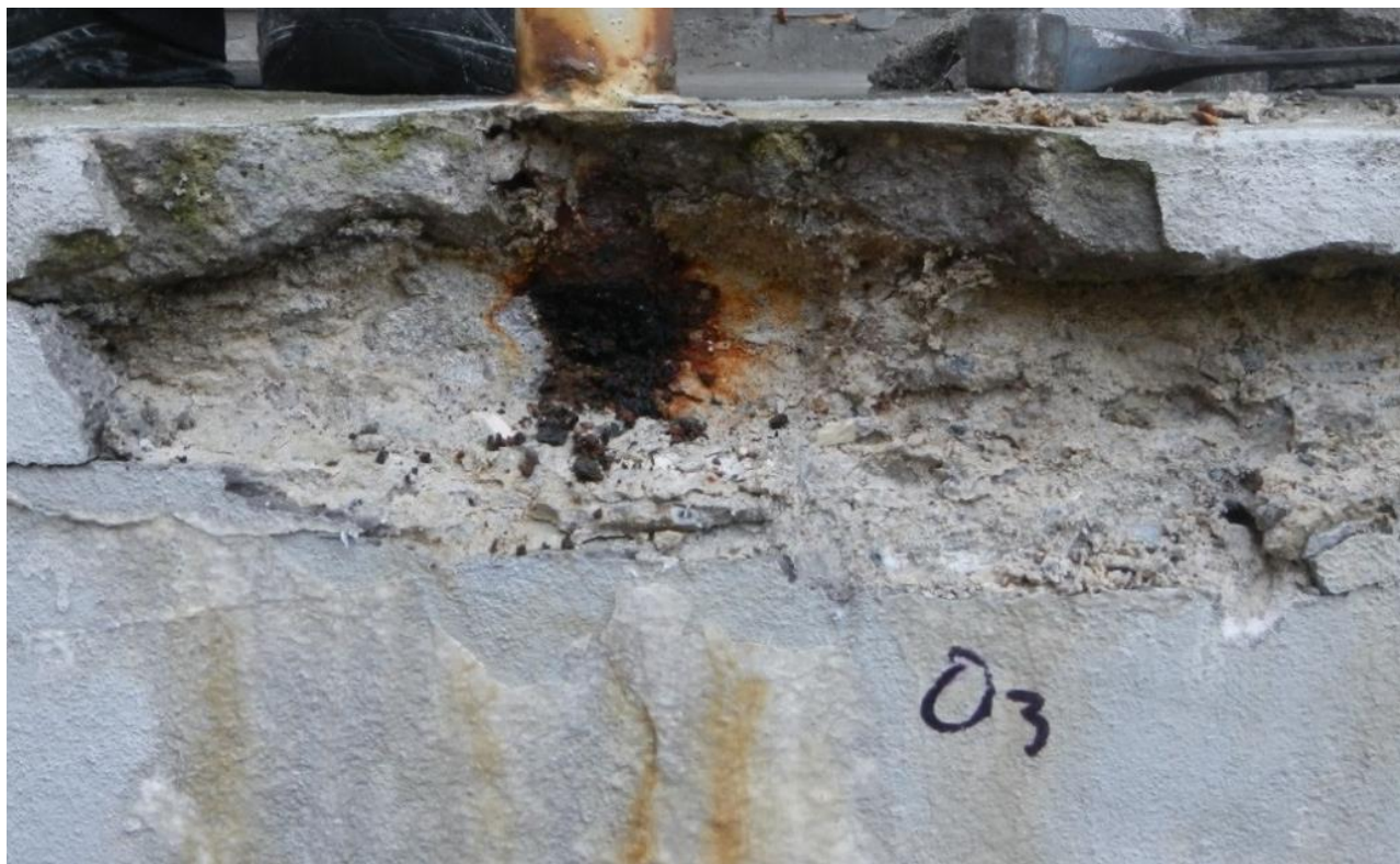
Figur 33. Korrosion i indstøbt scepterfæste for rækværk på svalegang. Højt chloridindhold i betonen, som stammer fra tørsaltning af svalegangen er i dette tilfælde årsag til korrosionen.
