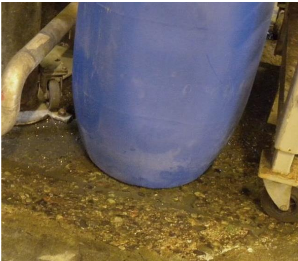
Figur 16. Eksempel på blottægning af tilslag, som er forårsaget af en kemisk nedbrydning af cementpastaen mellem tilslagene.
