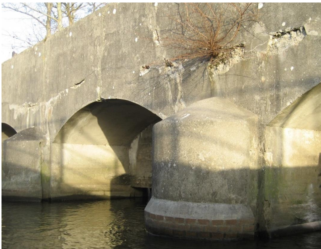
Figur 36. Vegetation i revne accelererer nedbrydningen af betonen.
