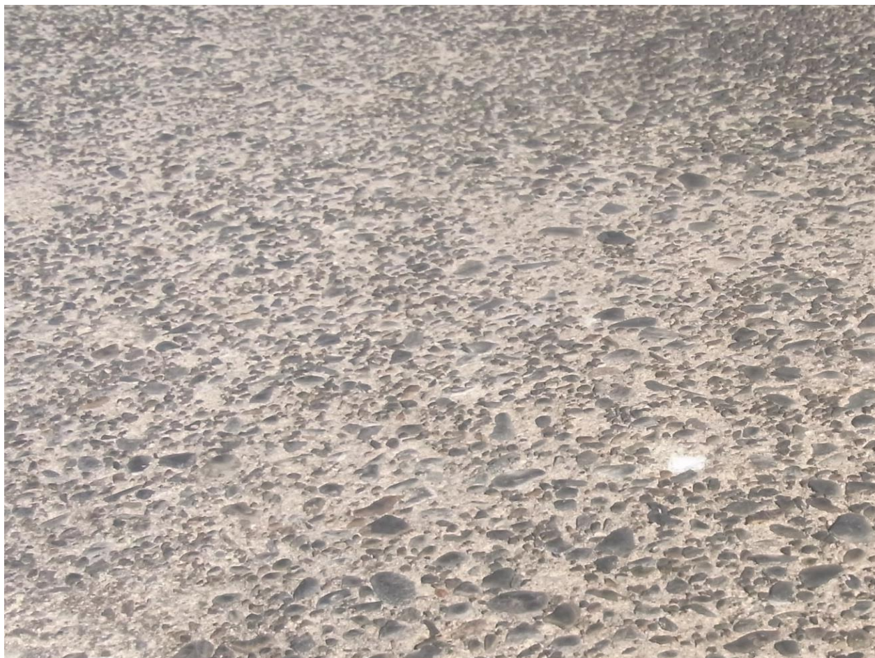
Figur 15. Fysisk betinget blotlægning af tilslag på betonoverflade forårsaget af erosion fra rindende vand.
