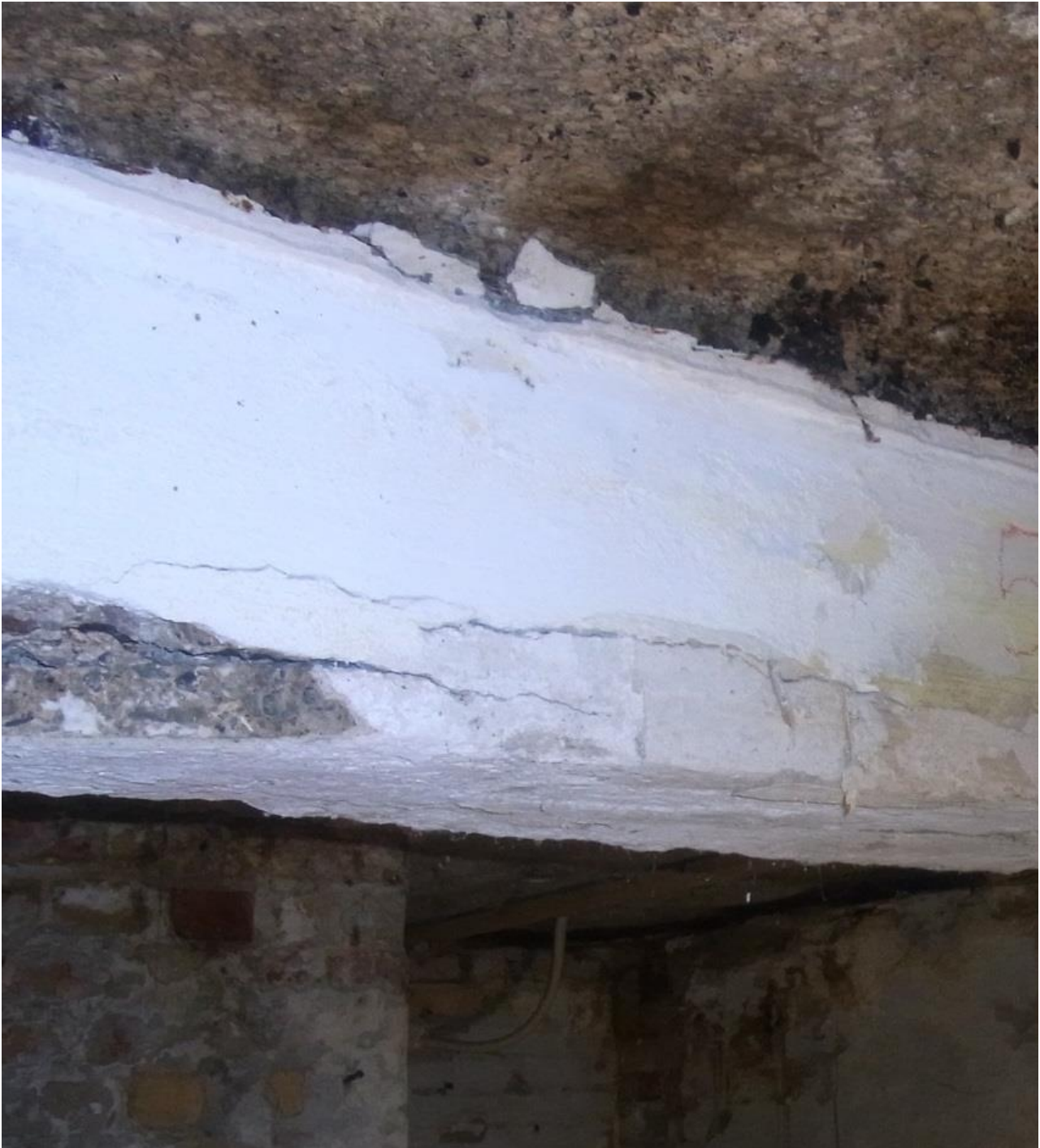
Figur 7. Afskalning over armering. Armeringsparallelle revner ses på bjælkens lodrette side og på underside. Revner og afskalninger af denne type vil ofte være forårsaget af korroderende armering. Under afskalningerne kan der observeres korroderet armering, og på overflader og i revner kan der ofte observeres brunlige udfældninger (rust).
