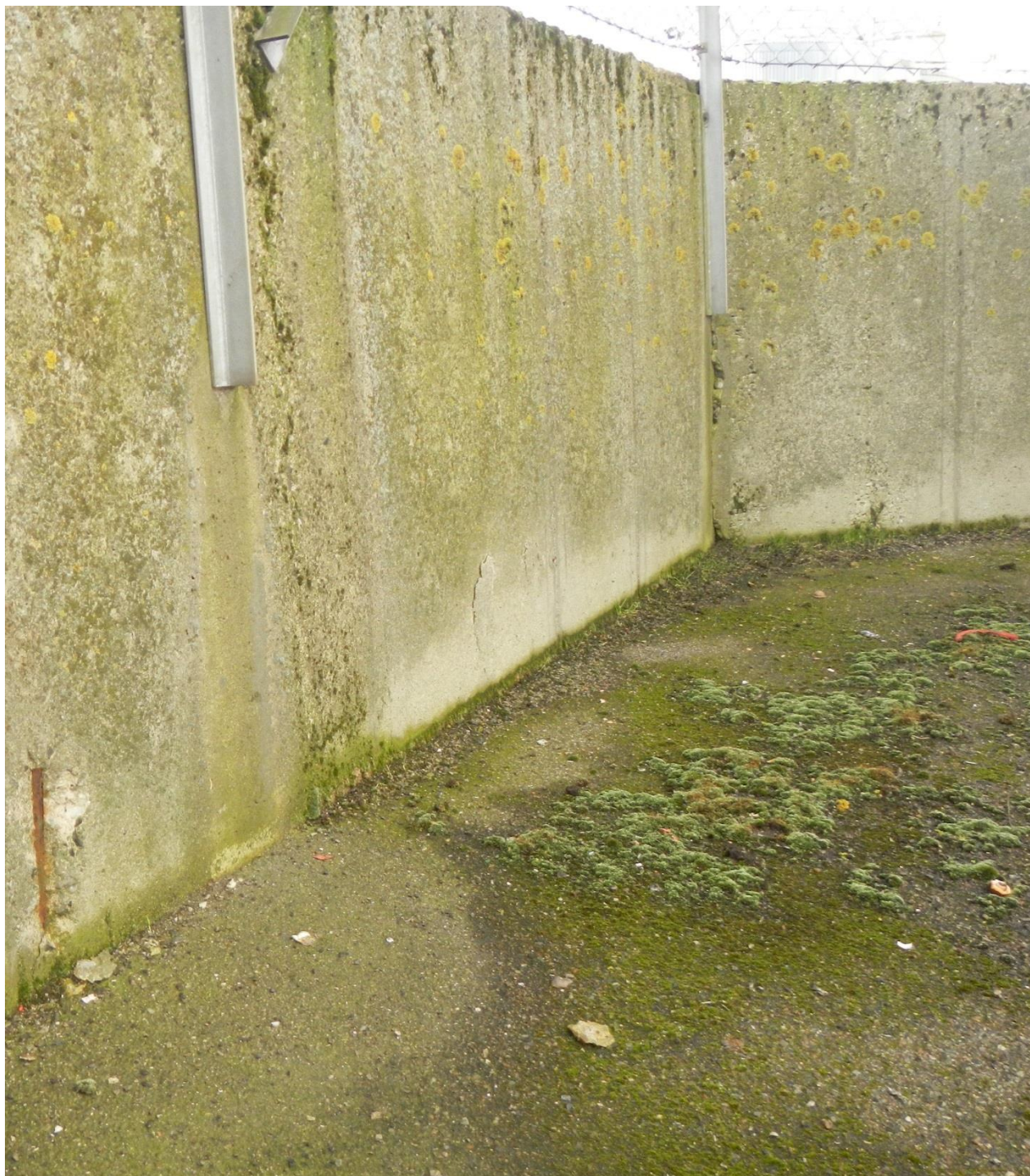
Figur 37. Mos- og lavdannelse på betonoverflader kan medføre øget nedbrydning pga. forøget fugtbelastning, men i mange tilfælde er der blot tale om et problem af æstetisk karakter.
