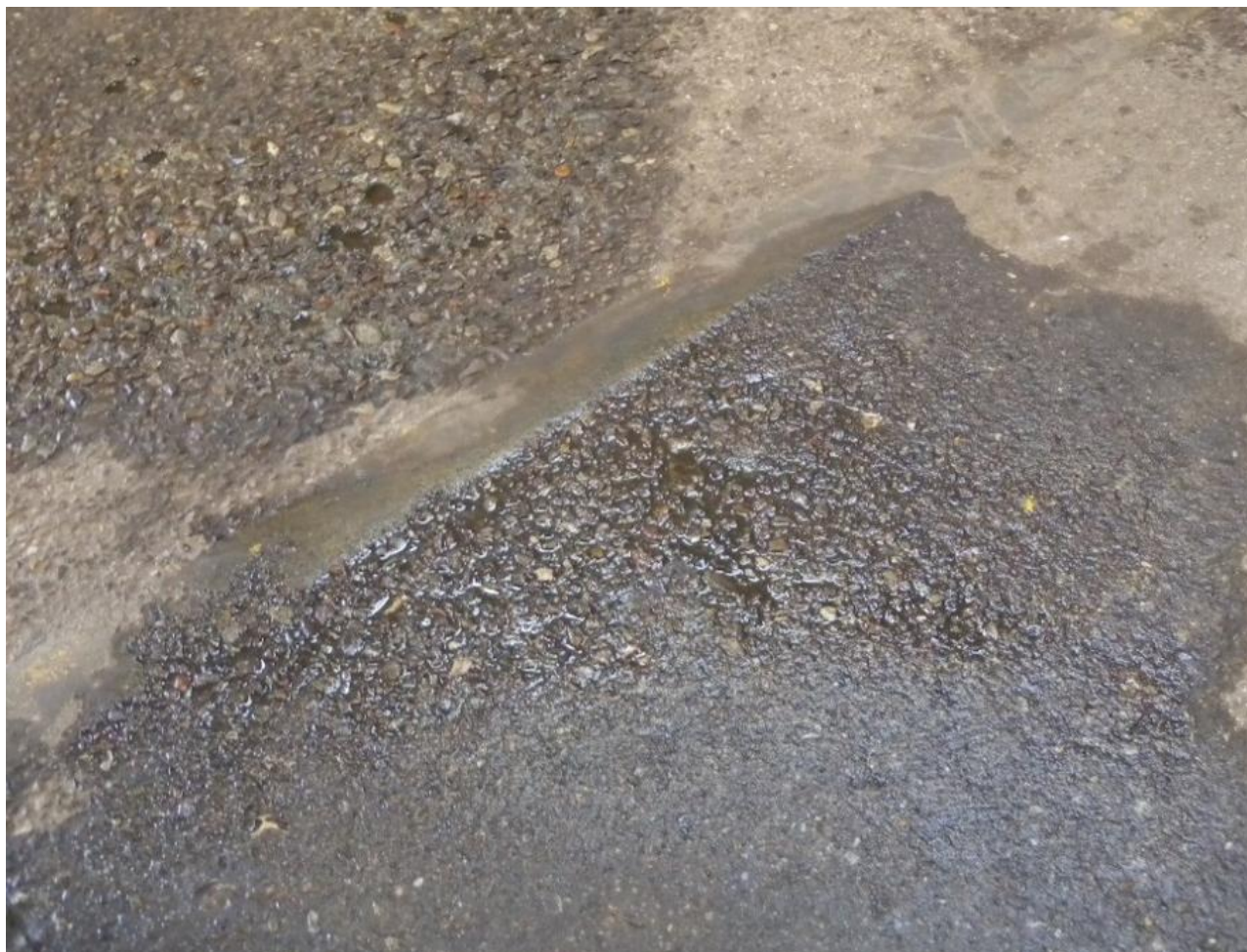
Figur 17. Blotlagt tilslag på betongulv i kunstgødningsfabrik. Kemisk nedbrydning.
