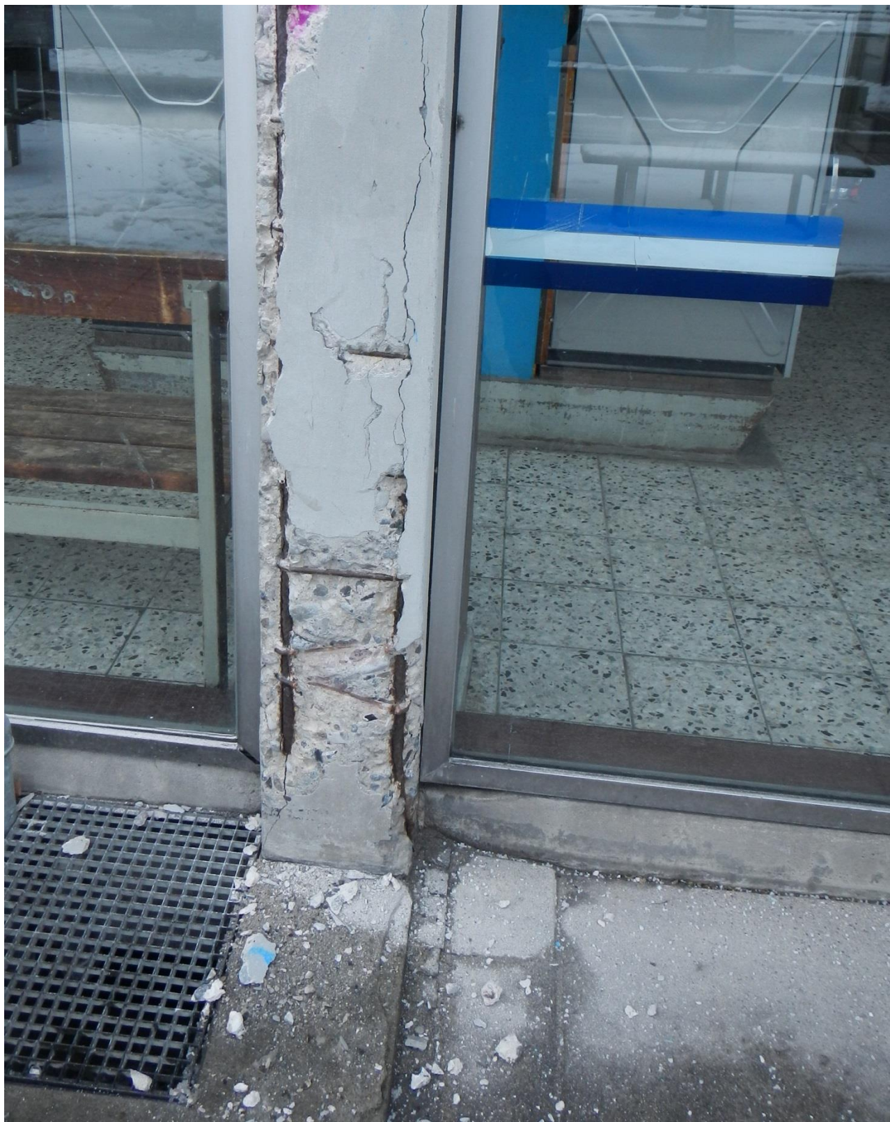
Figur 35. Armeringskorrosion i søjle har forårsaget dannelse af grove lodrette revner (parallelt med hovedarmering) og begyndende afskalninger og løstsiddende beton (dæklaget er lokalt fjernet ved behugning). Årsagen er her en kombination af højt chloridindhold i betonen samt karbonatiseret beton i armeringsniveau. Der er her tale om tydelig overfladerust, men stadig uden betydende tværsnitsreduktioner af armeringen.
