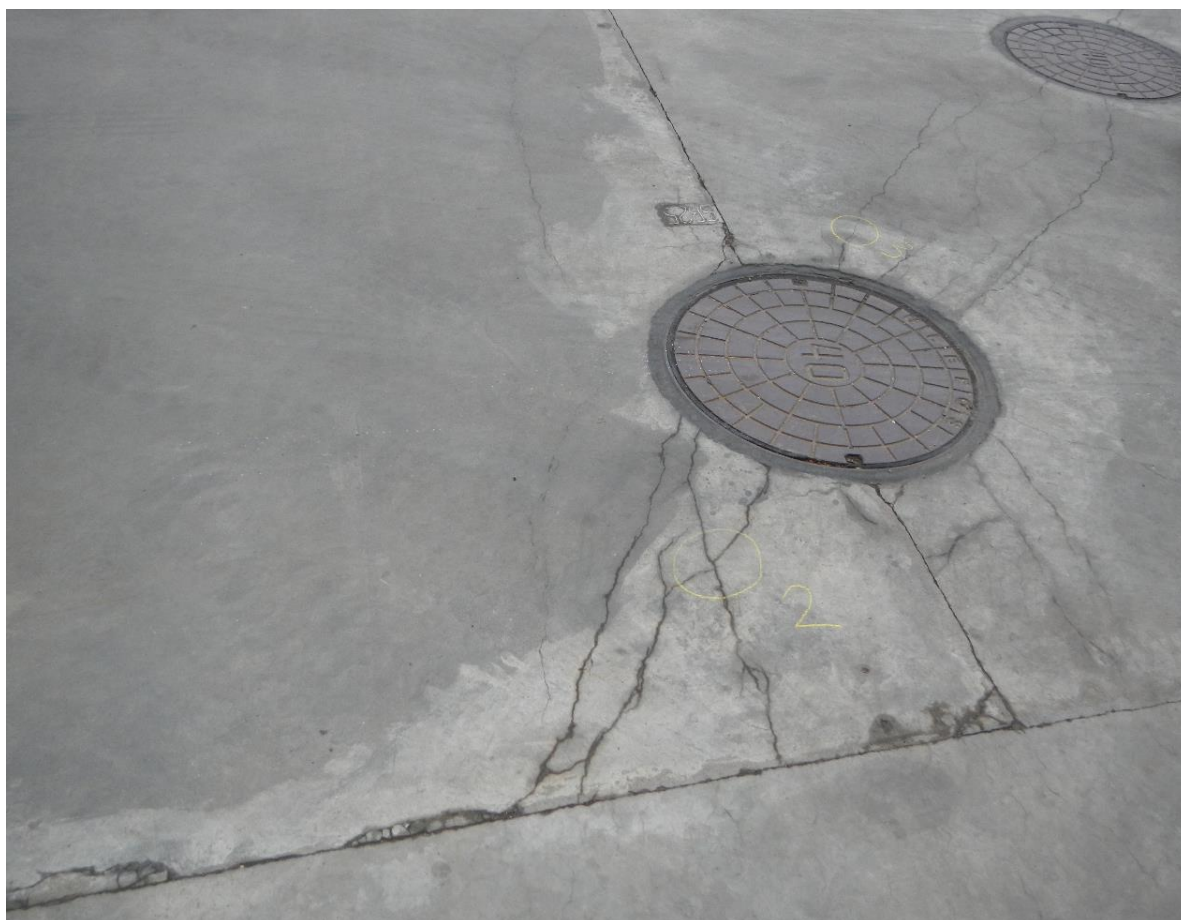
Figur 1. Revnedannelse i tungt trafikeret terrændæk. Revnedannelsen skyldes, at dækket er utilstrækkeligt armeret omkring brønden og derfor ikke kan modstå belastningerne fra den tunge trafik.
