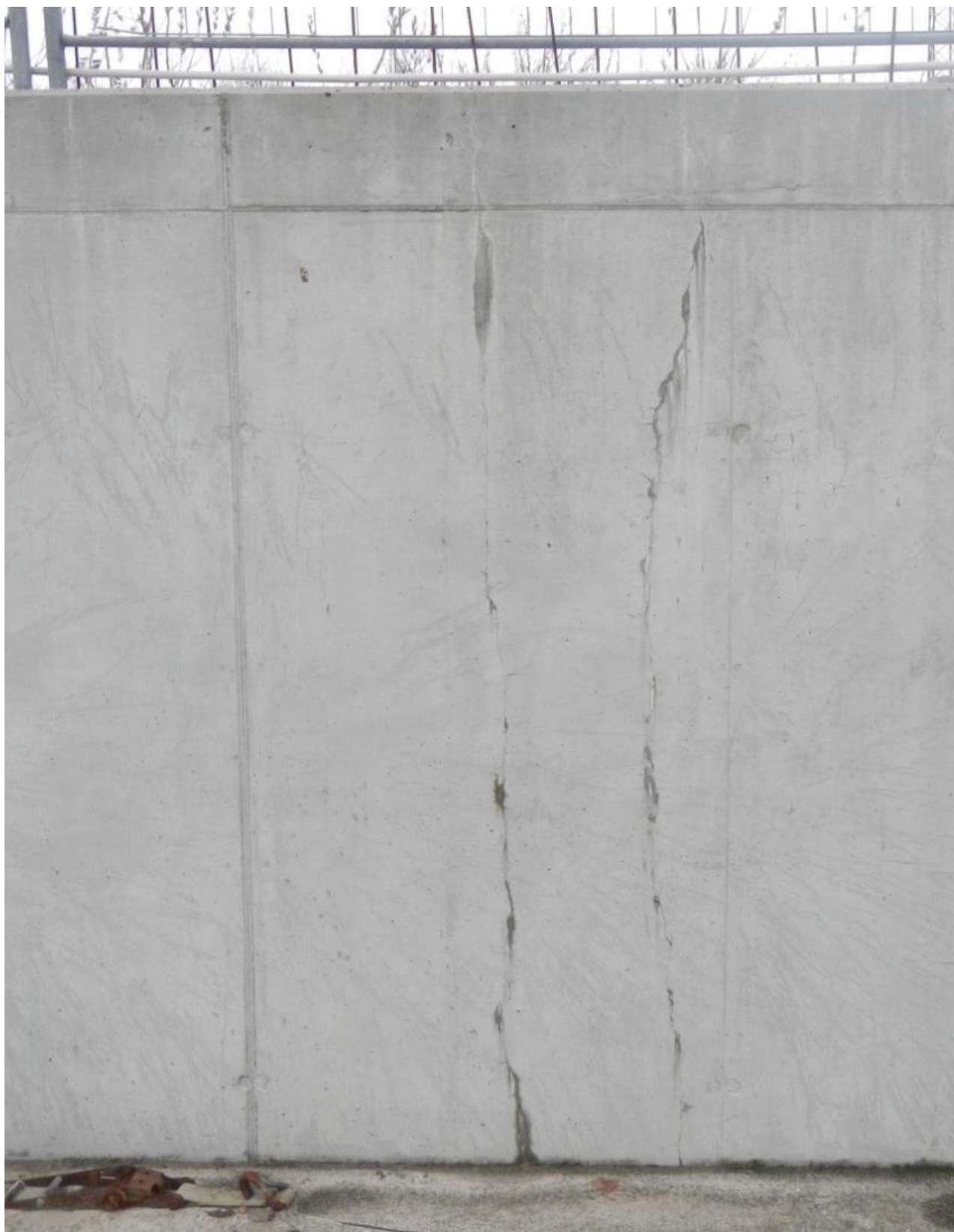
Figur 22. Lodret orienterede revner i kælderydervæg, som ses for ca. hver anden løbende meter. Revnerne er opstået enten på grund af udtørringssvind eller på grund af for stor temperaturforskel mellem væg og den underliggende konstruktion under hærkning (termorevner).
