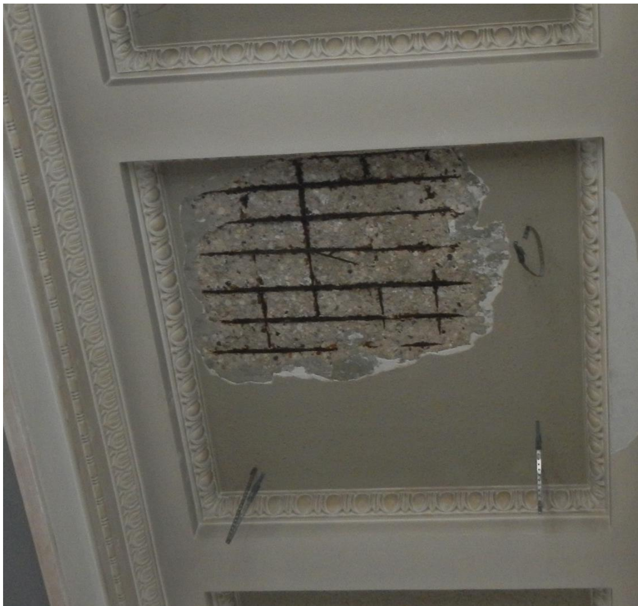
Figur 9. Afskalning i loft forårsaget af armeringskorrosion. Karbonatiseret beton samt utæt membran (vandindtrængning) er årsag til armeringskorrosionen.
