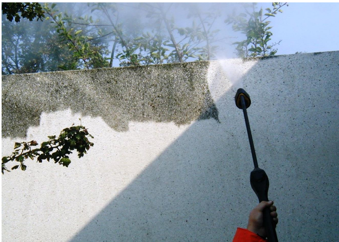
Figur 6. Rensemetoden bør vælges, så effekten af rensningen er let at følge for operatøren af rensedystret. Der anvendes ofte for lavt tryk og/eller for stor afstand til overfladen. Billedet viser et eksempel på en ca. 30 år gammel hvid betonoverflade, der bliver afrenset for tilsmudsning og alger ved højtryksspuling med rent vand. I én behandlingsgang fjernes hovedparten af misfarvningen. Den hvide overflade forblev ubehandlet efter rensningen.
