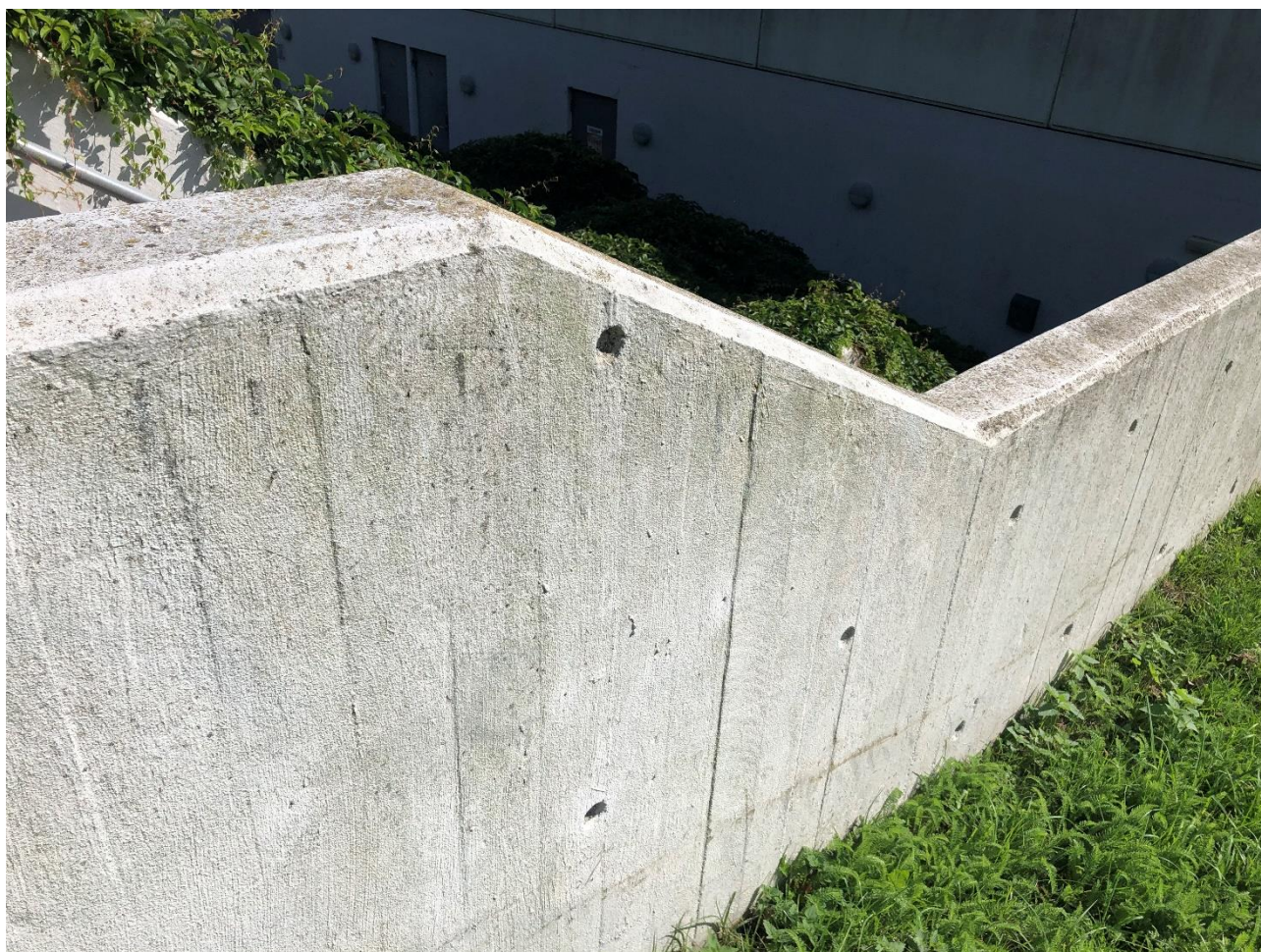
Figur 15. Eksempel på en malebehandlet betonoverflade ved en alder på 23 år. Overfladebehandlingen er tilsmudset/patineret med alger, men fremstår i øvrigt intakt. Og som udgangspunkt bør man acceptere, at der gror alger på bygninger eller at overflader på bygninger også patinerer. Når først overfladen er beskyttet tilstrækkeligt har de alene kosmetisk betydning. Betonen blev da også overfladebehandlet for at beskytte imod for hastig karbonatisering på et tidspunkt, hvor spredte dæklagsskader allerede var opstået. De blev repareret og overfladerne blev generelt overfladebehandlet, hvorefter der ikke har været nogen udvikling af dæklagsskader. Man ser, at den oprindelige bræddestruktur er bevaret på trods af overfladebehandlingen.
