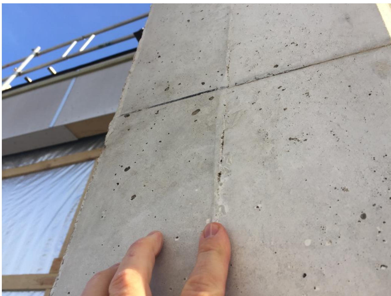
Figur 4. Eksempel på en glat betonoverflade med et utilfredsstillende udseende. Der ses tydelige spor af formpladesamlings samt en uensartet og stedvis stor forekomst af porehuller. Den arkitektoniske tanke var, at overfladerne skulle fremstå som ensartet glat beton. Overfladebehandling er på grund af overfladens karakter derfor ikke en mulig/oplagt løsning. Problemstillingen skulle man derfor have forsøgt at forudse allerede på planlægningsstadiet, så man fik etableret en vis sikker formodning om, at det ønskede resultat kunne opnås ved produktionen af betonen.
