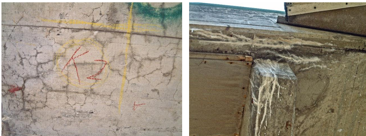
Figur 10: Foto tv. viser netrevnedannelser på undersiden af en bro, og th. ses revner og massive hvide kalkudfældninger under en kantbjælke. Strukturanalysen kan kigge ind i konstruktionen og se dybde af angreb samt årsagerne til de skader, der er synlige på overfladen, også lang tid før de udvikles så kraftigt som på fotos ovenfor.
